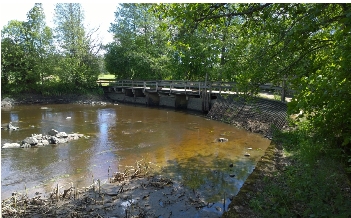
Kuva 6. Patoallas kuivana. Ylivirtaamalla padon vedenjohtokyky ei riitä ja osa virtaamasta purkautuu kuvan oikealla puolella olevan reunamuurin yli maa-alueelle. Tällöin vesi virtaa myllypihan kautta alakanavaan ja aiheuttaa haittaa tilan rakenteille.
